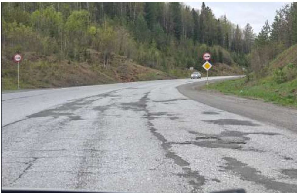
После г. Дивногорска качество дорожного покрытия испортилось.
