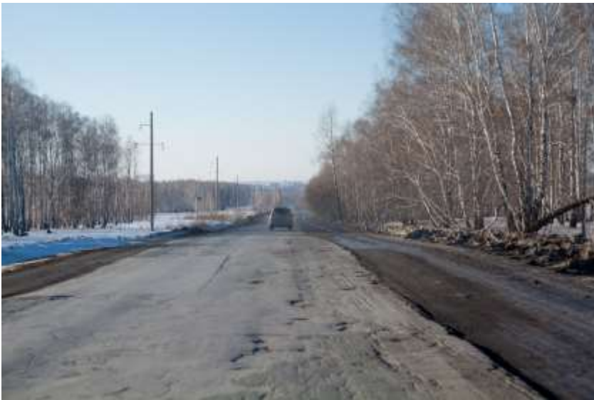
Неровности дороги, разрушение дорожного полотна.
